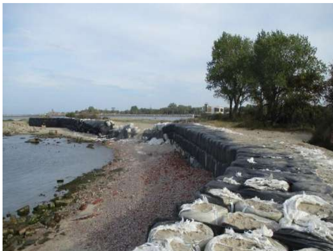
Б – Поврежденные геоконтейнеры искусственной авантюны
