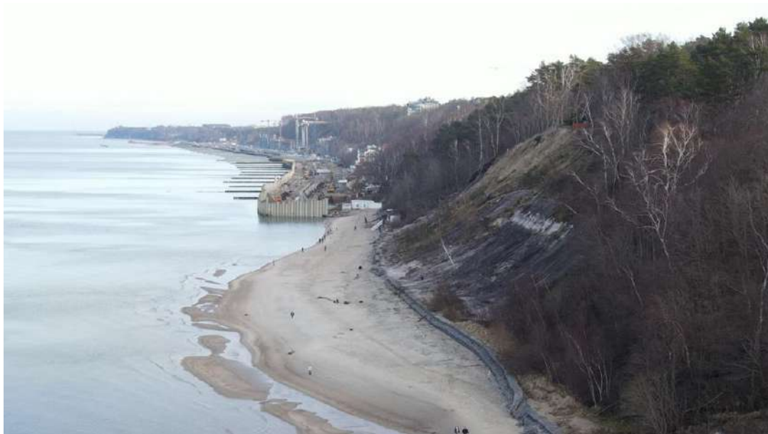
Рис. 3.9. Аварийный участок оползнеопасного берега в г. Светлогорске в районе спуска с ул. Московская.
